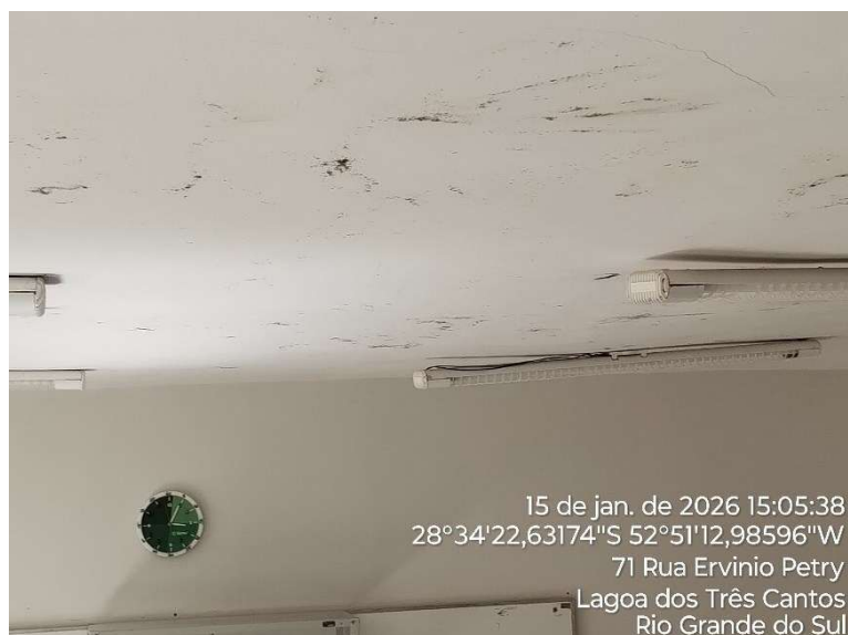
Figura 2: Flecha na laje, sala 02
