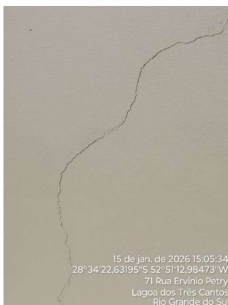
Figura 3: fissura no revestimento da laje
