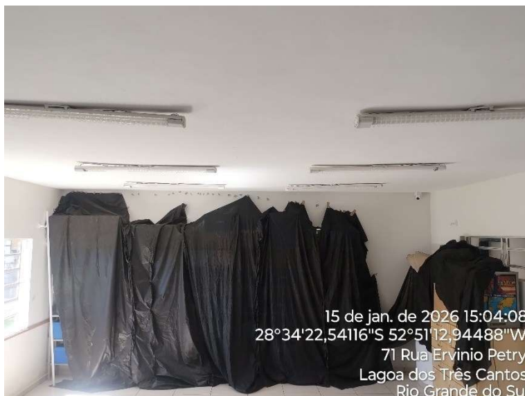
Figura 1: Flecha da laje, sala 01
