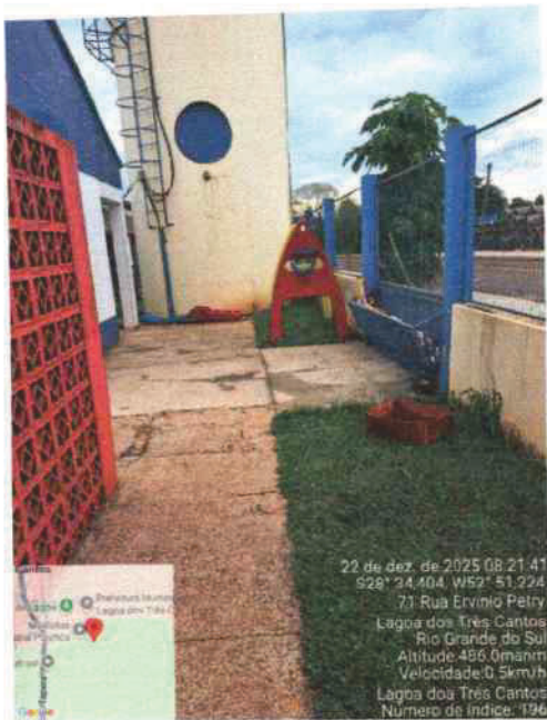
Demolição da calçada e execução de calçada nova. Execução de rampa, onde está a lixeira e adequação do portão no local.
