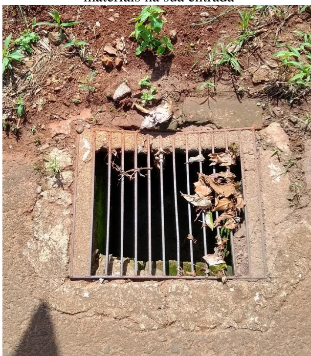
Figura 50. Modelo de boca de lobo instalada na área urbana
