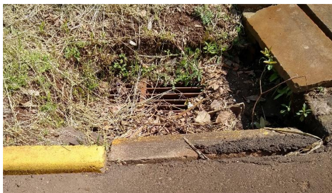
Figura 49. Modelo de boca de lobo instalada na área urbana, porém com acúmulo de materiais na sua entrada
